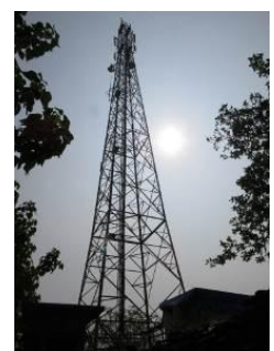
集落中心部の電波塔 （ここに基地局を設置）
