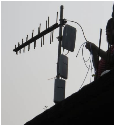
図2 民家屋上に設置したアンテナ
