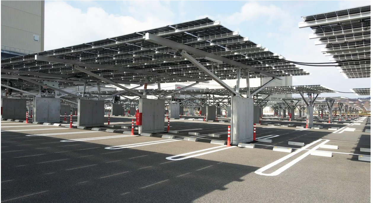
No2ソーラーパワープラント 駐車エリアに支柱が無く利便性の向上が期待できるデザイン
