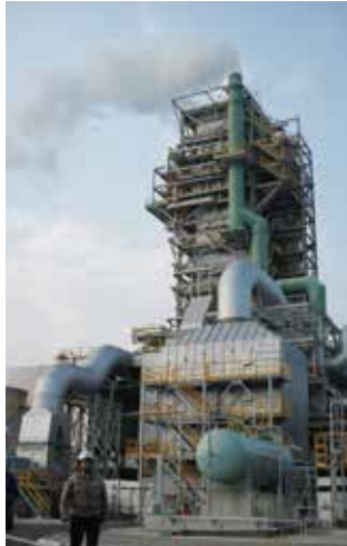
▲ボイラーの高さは地上およそ60m
