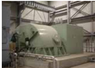
▲24時間稼働しているタービン
