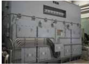
▲発電機、ここで電気が作られる
