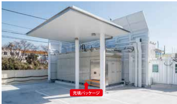
水素充填パッケージ(写真中央の設備)
