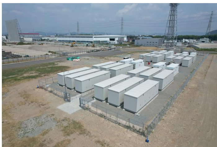
（姫路蓄電所／2025 年 8 月撮影）
