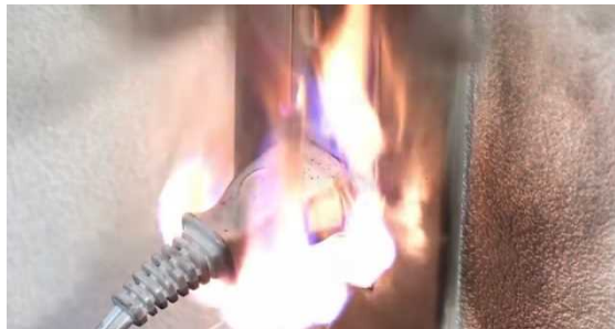
外力で変形・破損した電源プラグの発火
