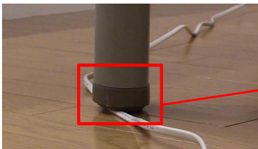
電源コードを踏みつけている様子
