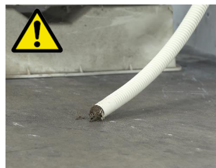
排出口が詰まっている状態
