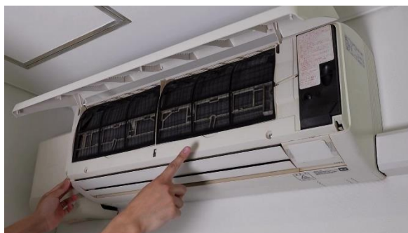
エアコンのフィルターを確認
