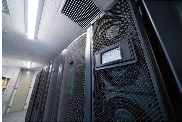
図：田辺市役所に導入された InRow 空調機
