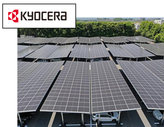
京セラの PPA サービス (写真:滋賀野洲工場 ソーラーカーポート)
