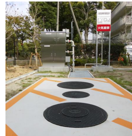
地下オイルタンク
