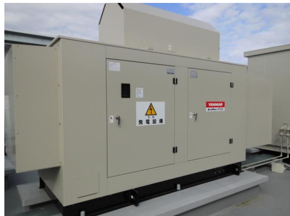
非常用発電機
