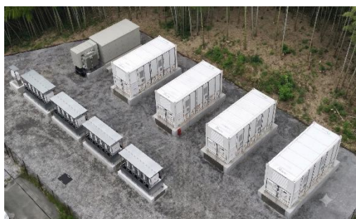
宮城県大崎市蓄電所
