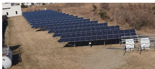
[ 鹿嶋市浄化センター300KW アカミネ PPA 太陽光発電所]
