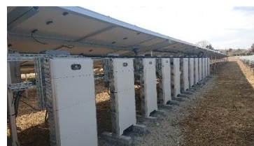
[自社・蓄電池併設型太陽光発電実証設備]
